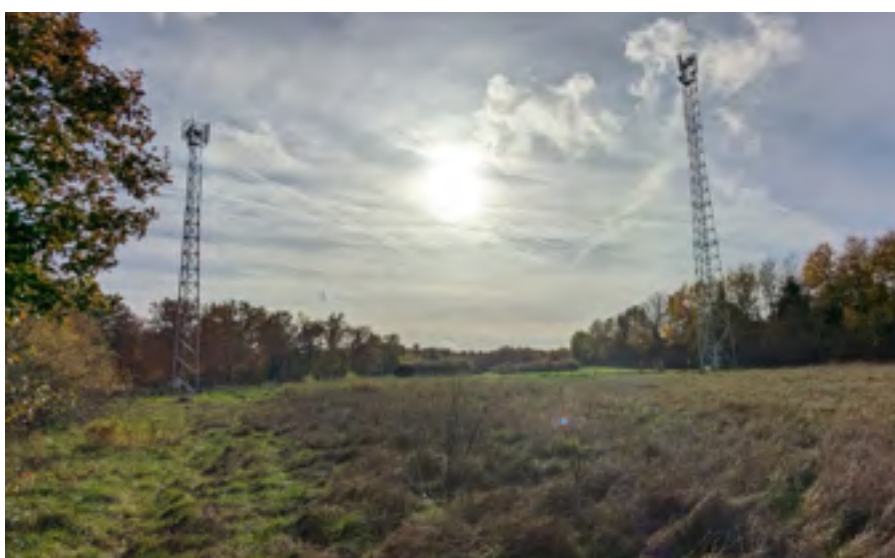
▲ Les deux antennes en place ; à gauche l'antenne TDF de 2017 (non utilisée) ; à droite, la nouvelle antenne Bouygues © Séverine Villey
